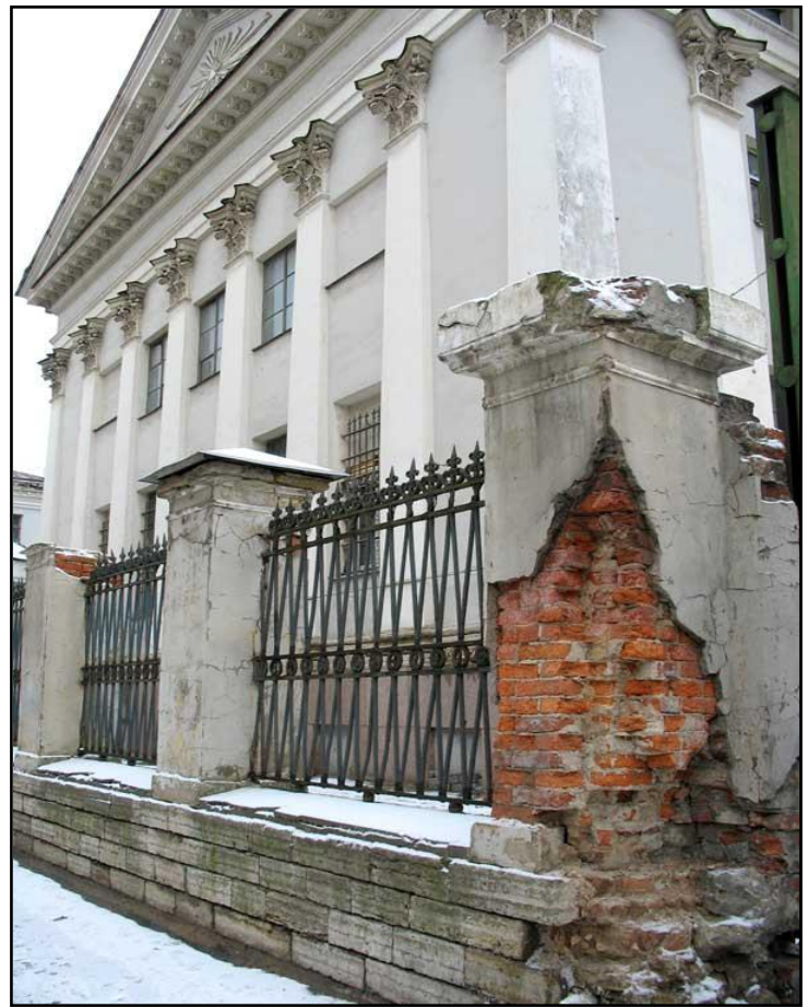
Рисунок 4. Фрагмент разрушенной ограды церкви
